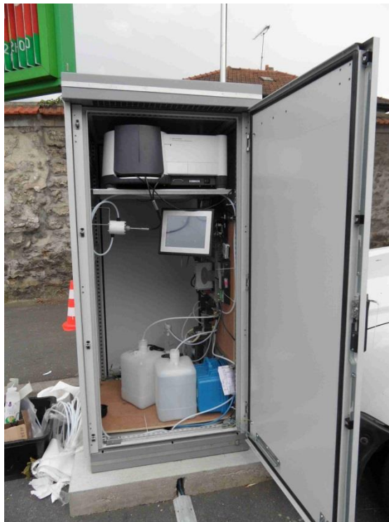
Figure 12 Installation du spectrofluorimètre sur le site expérimental du bassin versant routier du projet Trafipollu
