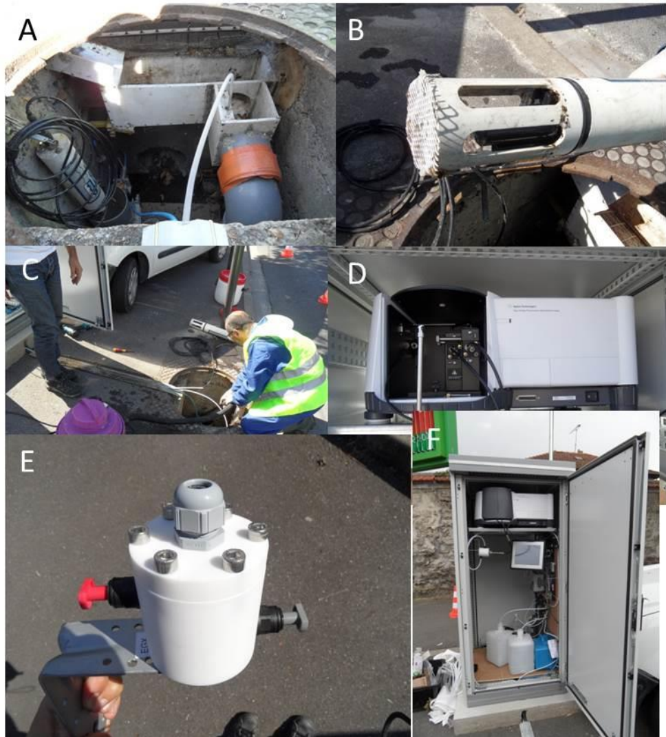
Figure 2 Dispositif expérimental mis en place au niveau de l'avaloir destiné à observer le bassin versant routier Trafipollu (A : collecte de l'eau ; B : sonde multiparamètre ; C : maintenance hebdomadaire ; D : spectrofluorimètre 3D mis en place sur le terrain pour la mesure dynamique de la concentration en HAP ; E : chambre de mesures pour la sonde à HAP ; F : Armoire de mesures au complet)
