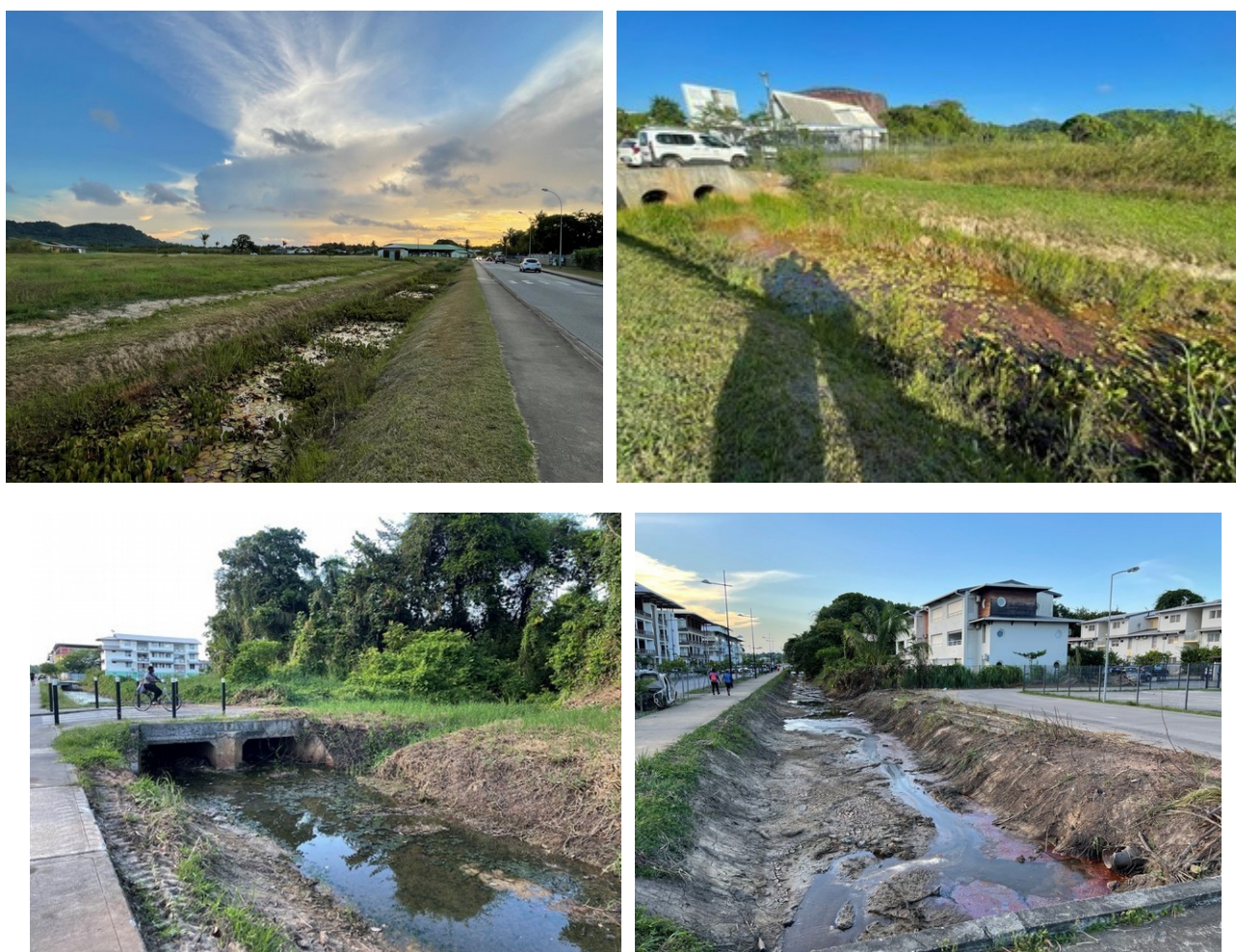
Illustration 5 : En haut, le Canal Michotte, Rémire – Arboré ou géonatte avec couvre-sol (Crédits photos : Astrid Abel). En bas, le Canal Hibiscus, Cayenne. Solution proposée : Enrochement avec héliophytes (Crédits photos : Astrid Abel).
