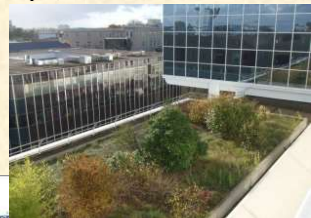
Toiture végétalisée CHU Rennes (F)
