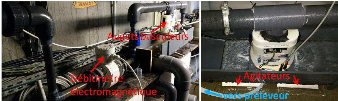
Figure 2. Systèmes de mesure et de collecte équipant les sorties de drains et de surface (noue standard).
