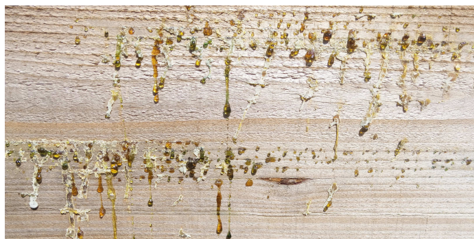
Fig. 1 : Exsudation de résine sur un bardage extérieur
