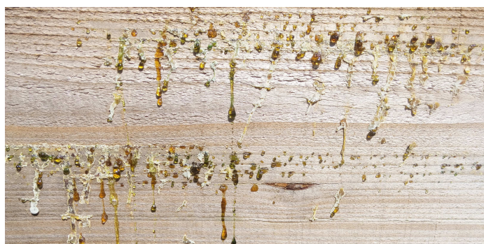
Fig. 1 : Exsudation de résine sur un bardage extérieur
