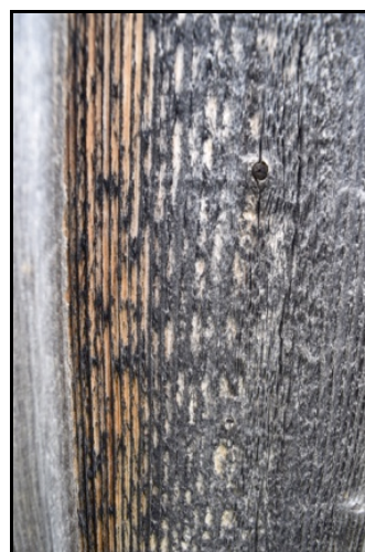
Fig. 2 : Exemple de dégradation par la pluie
