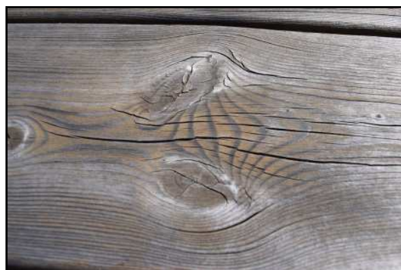
Fig. 1 : Exemple de dégradation par l'ensoleillement
