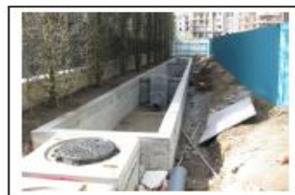
Dépollution par filtre à sable
