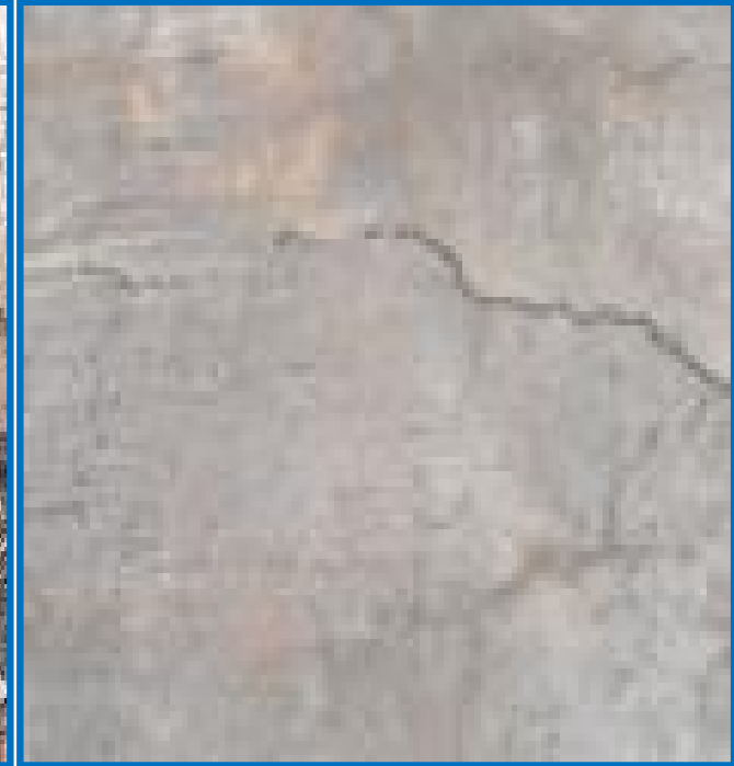
Craquelage de la surface de béton dû au retrait du béton
