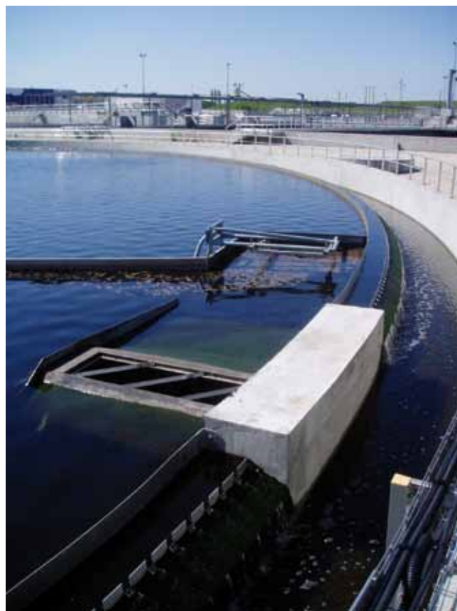
Station d'épuration des eaux usées urbaines : site de Seine-Amont à Valenton (Val de Marne).
